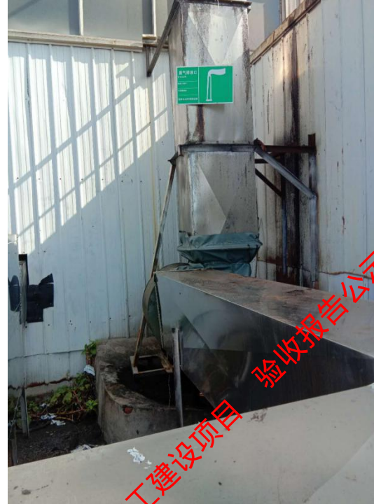
油炸废气排放口标识牌
