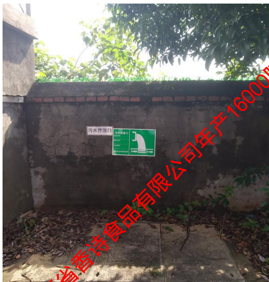
废水排放口标识牌
