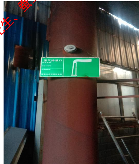
锅炉废气排放口标识牌
