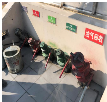
卸油油气回收系统
