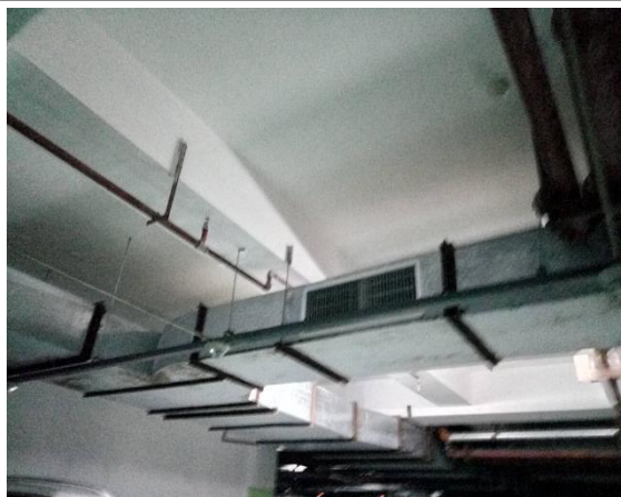
地下车库排烟管道
