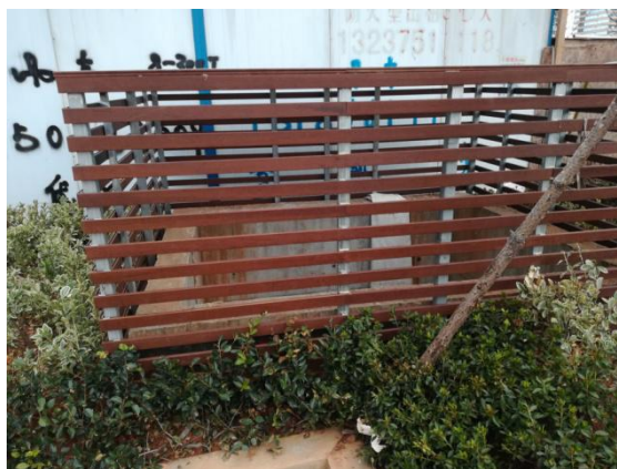
地下车库排烟口
