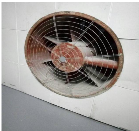
备用发电机房风机
